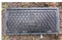
直結止水栓 （メーターボックス）
