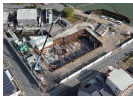
排水対策の一つ、新三川ポンプ場
